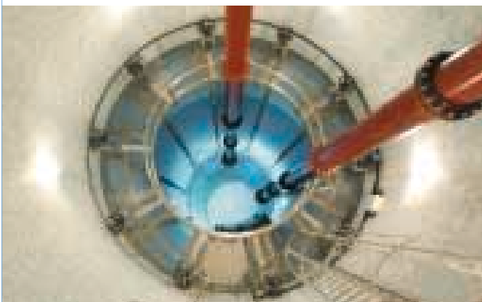
Usine de pompage de Saint-Priest
